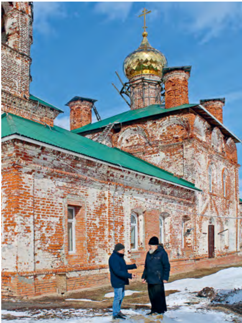
Вознесенская церковь в с. Семеть, требующая срочного ремонта. Протоиерей Александр Николаев проводит импровизированное совещание с приходским старостой
