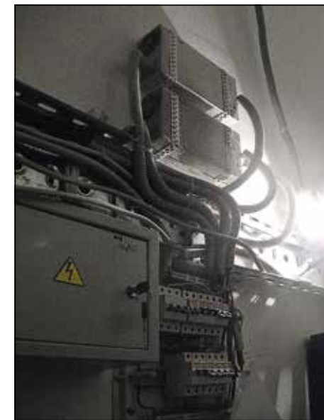
Ил. 9. Типовое вспомогательное оборудование с трансформатором
