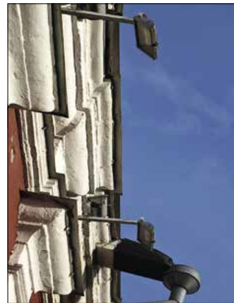
Ил. 10. Приборы локального освещения на кронштейнах у фасадной стены
