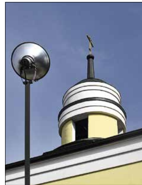
Ил. 8. Прожектор заливающего освещения на самостоятельной опоре
