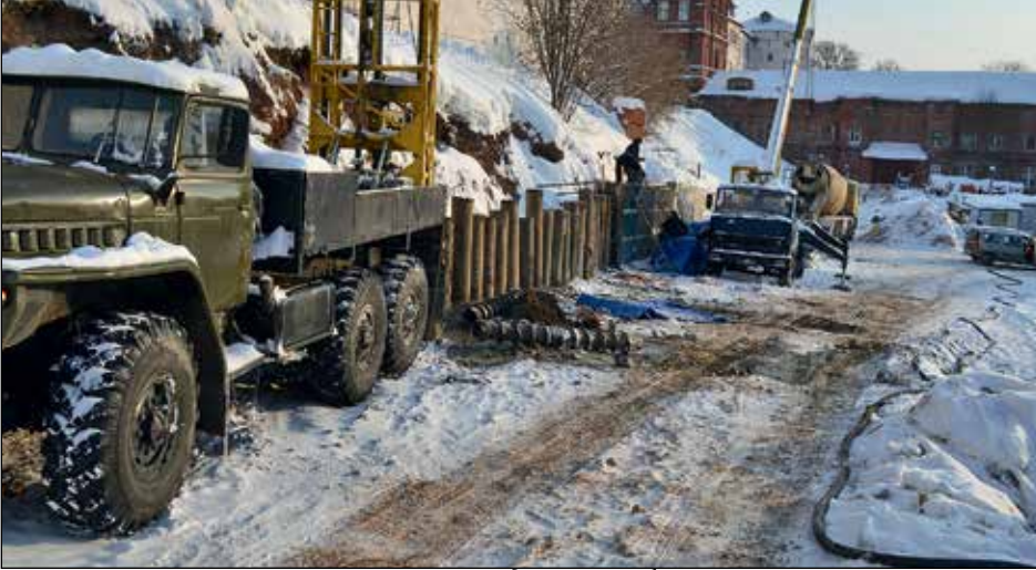
Зима 2012–2013. На стройплощадке нового общежития укрепляют западный склон и конструкции Плотничьей башни
